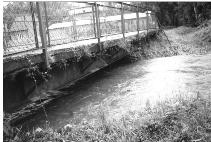
Do tego mostu (ulica Rakuś) „brakło” 20 cm.
